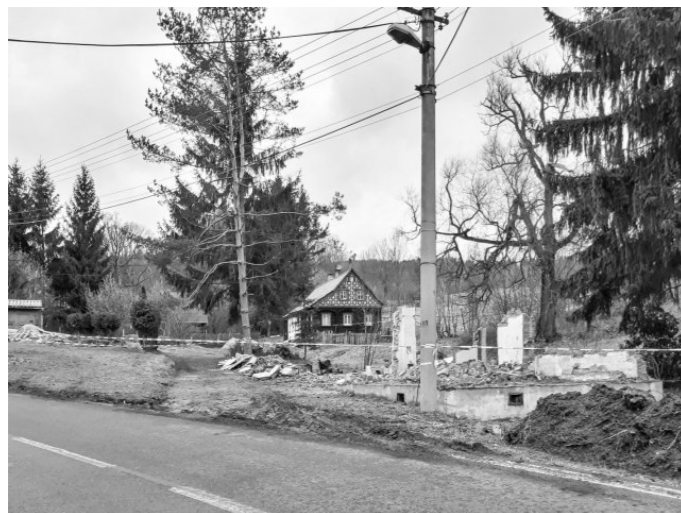
Brtníky č. ev. 36 - Pohled na zboření stavení (Zdroj: S. Šulcová, 2018)
