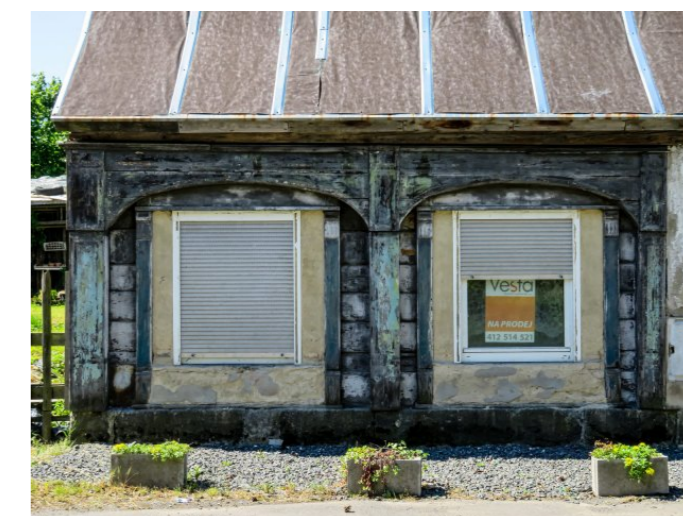
Mikulášovice č. p. 285 - Detail podstávkového pole s okenními otvory (Zdroj: S. Šulcová, 2017)
