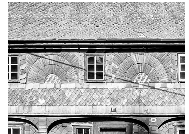
Mikulášovice č. p. 311 - Detail obložení (Zdroj: S. Šulcová, 2024)
